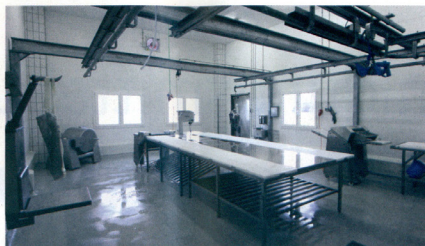
Schon bei der Planung sollte berücksichtigt werden, dass die personal- und zeitintensive Reinigung leicht durchzuführen ist. | Fotos: egs
